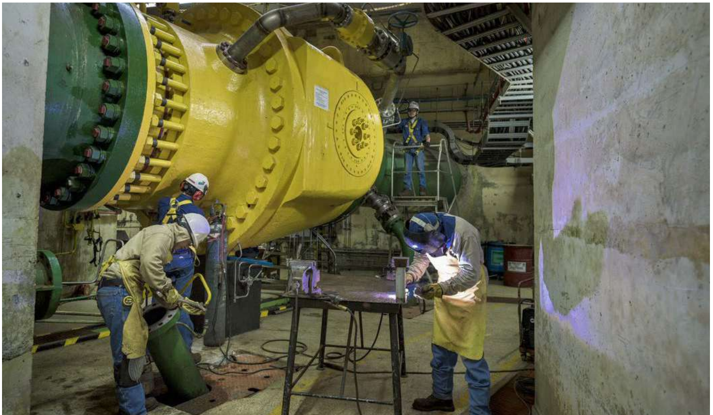
Casa de Máquinas, Central Chivor
